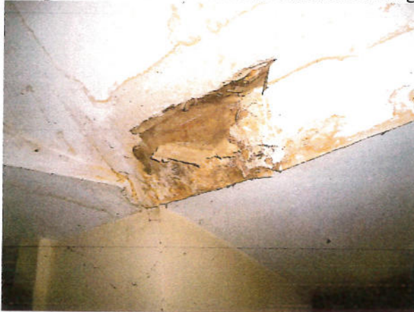
Beispiel alte Wasserschäden Dachverkleidung
