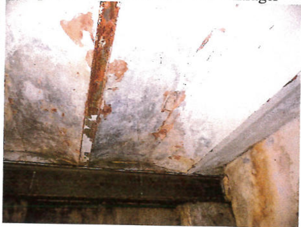
Beispiel Korrosionsschäden Deckenträger
