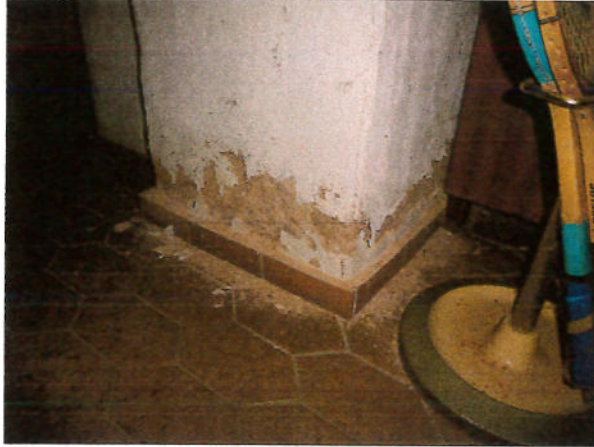
Beispiel Feuchteschäden KG
