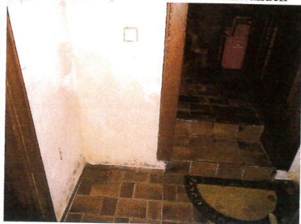
Feuchteschäden, teils auch an Innenwänden
