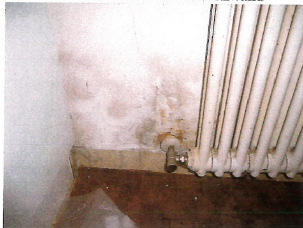
Detail Feuchteschäden KG-Außenwand
