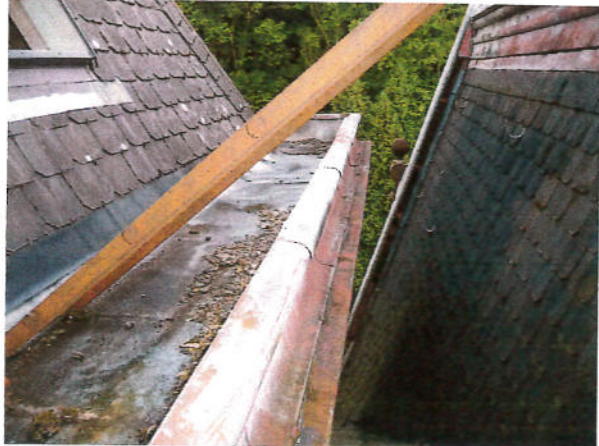
sehr aufwendige Dachanschlüsse
